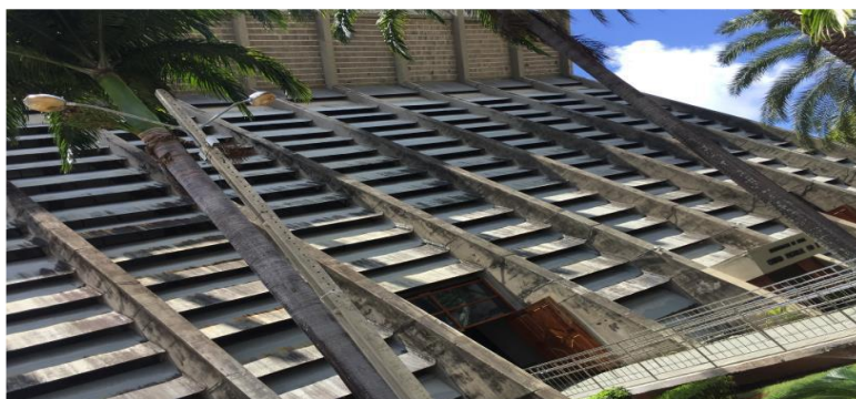
Figura 3 - Ausência de manutenção nas placas metálicas
