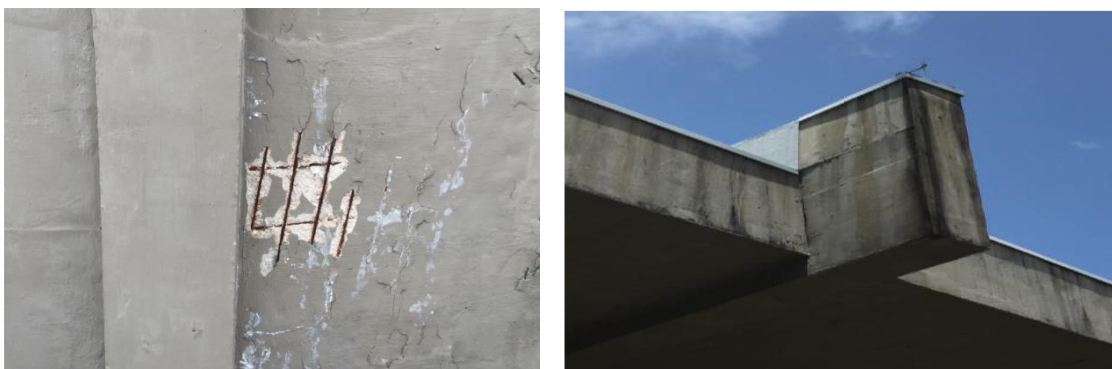
Figura 1 e 2 - Corrosão linear na laje de fundo e ausência de pingadeiras na viga protendida.
