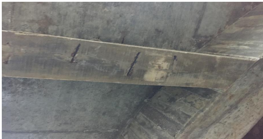
Figura 4 – Corrosão nas peças internas da Catedral.
