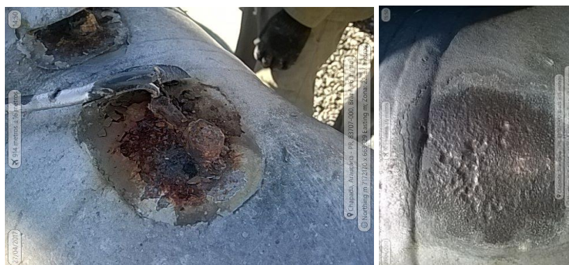
Figura 2: Defeito típico de corrosão sob a massa epóxi
