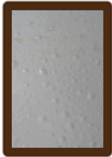
Figura 7- Esquema AD - Imersão em água DI. Revestimento aplicado na unidade da Vale em São Luís. Grau de empolamento 3(S5).
