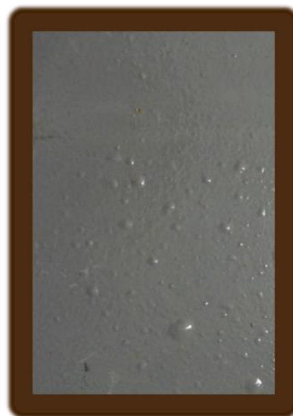
Figura 9 - Esquema CD - Imersão em água DI. Revestimento aplicado na unidade da Vale em São Luís. Grau de empolamento 3(S5).
