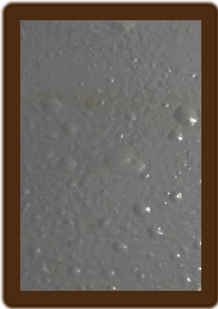
Figura 6 - Esquema GH - Imersão em água DI. Revestimento aplicado na unidade da Vale em São Luís. Grau de empolamento 4(S5).
